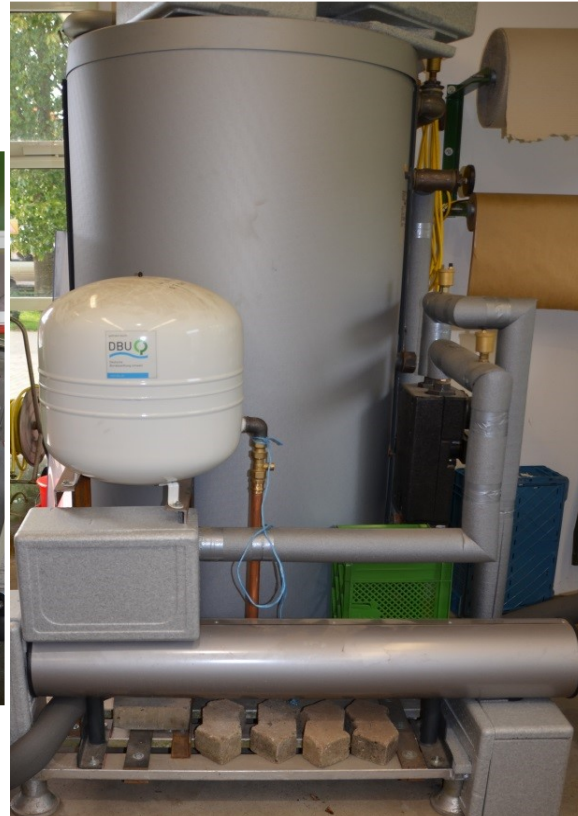
Wärmespeicher und -tauscher
